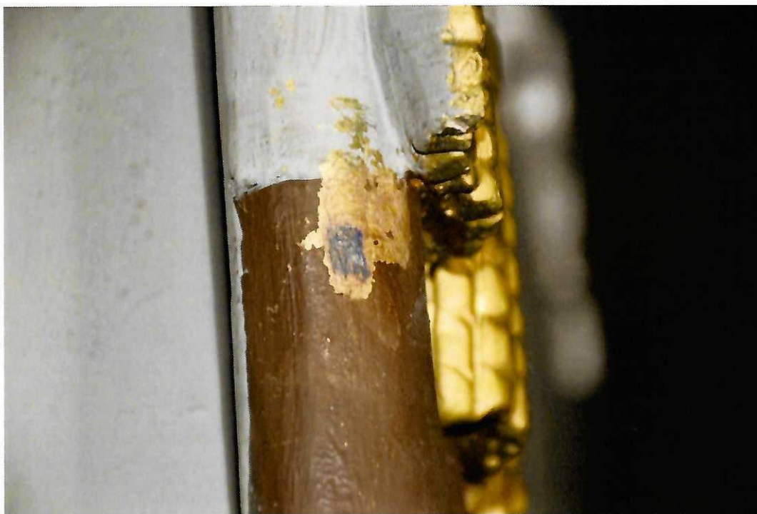
Fot.7. Modlnica, Kościół pw. św. Wojciecha i Matki Boskiej, Wnętrze nawy kościoła, Widok na fragment prospektu organowego. Widoczny ubytek przemalowań i fragmenty wcześniejszych polichromii zauważalnych w odkrywce. Fot. I.Widlińska, 2023 r.
